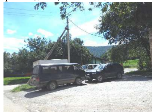
Опора ЛЭП жилого дома ул. Набережная, д. 12, 12.07.2023, 13:25
