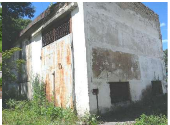
Трансформаторная подстанция жилого дома ул. Набережная, 6, 11.07.2023г. 12:33
